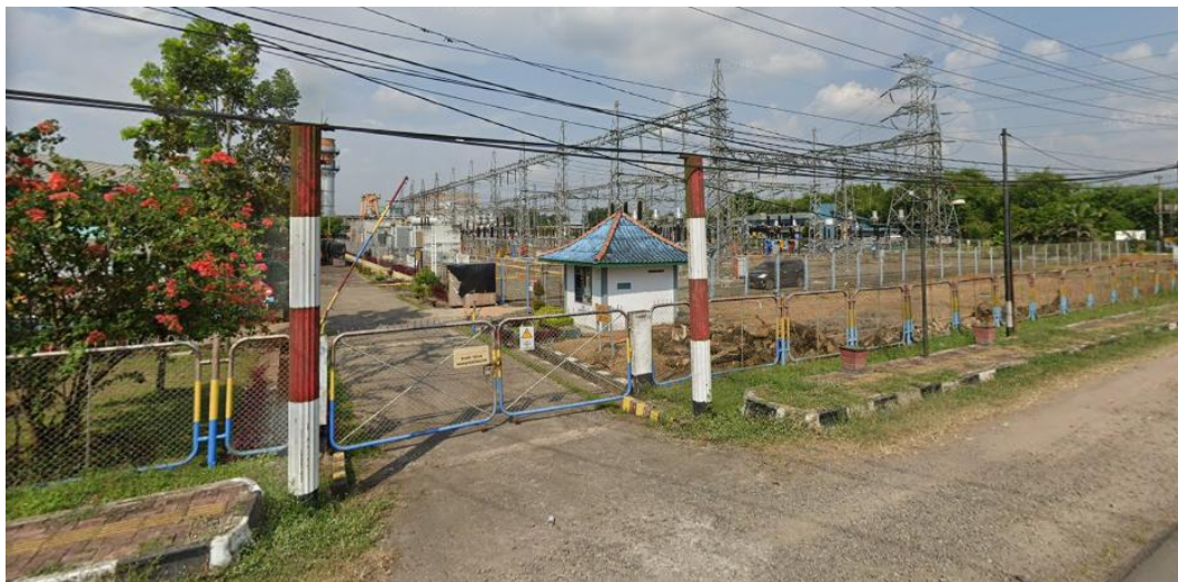
Gambar 2.2 Gambar Gardu Induk 150 kV
