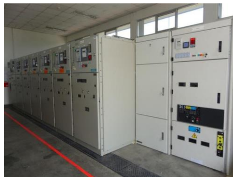
Gambar 2.9 Panel Kontrol Utama
