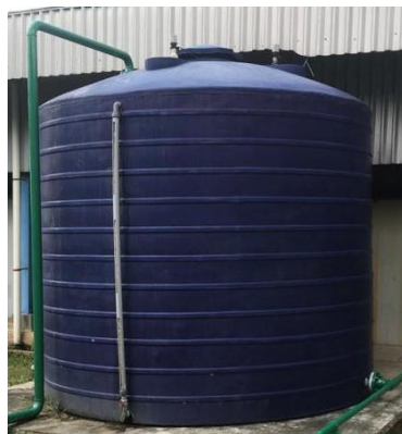
Gambar 2.9 Clarifier Tank di PLTG Borang (Sumber : PLTG Borang, 2021)
