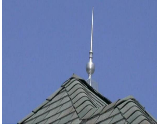
Gambar 2.1 Batang penangkal petir diatas gedung
