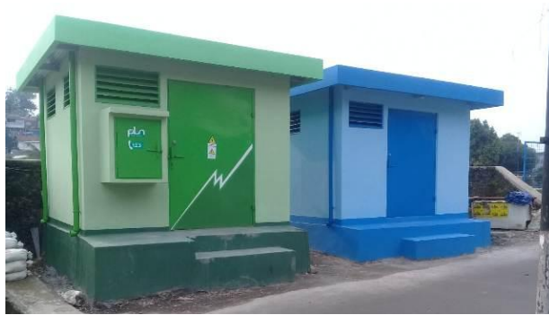
Gambar 2.11 Gardu Tipe Beton
