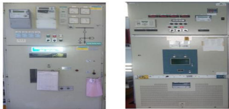
Gambar 2.3 Kubikel Incoming di GIS Kotim
