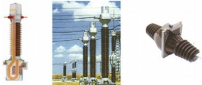
Gambar 2.16 Trafo Arus Pemasangan Outdoor
