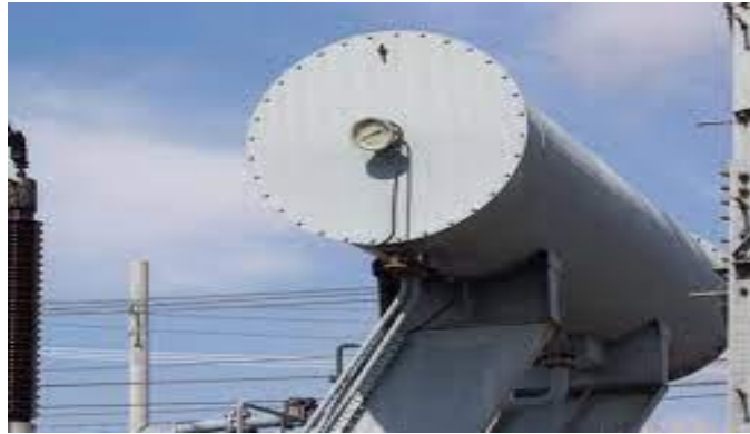
Gambar 2.5 Konservator minyak trafo(tanky)
