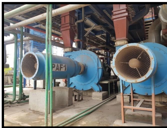
Gambar 2. 16 Primary Air Fan (Sumber: Dokumentasi Pribadi)
