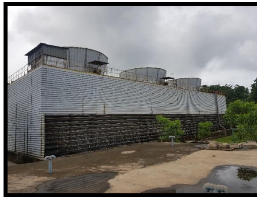
Gambar 2. 5 Cooling Tower (Sumber: Dokumentasi Pribadi)
