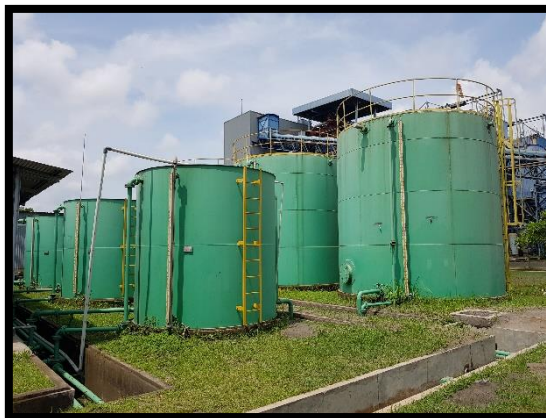
Gambar 2. 13 Demin Tank (Sumber: Dokumentasi Pribadi)
