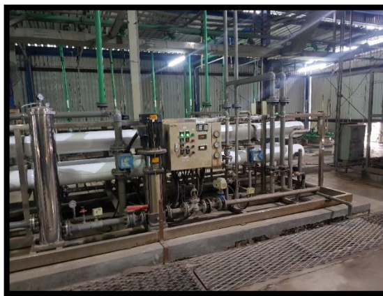
Gambar 2. 11 Reverse Osmosis II (Sumber: Dokumentasi Pribadi)
