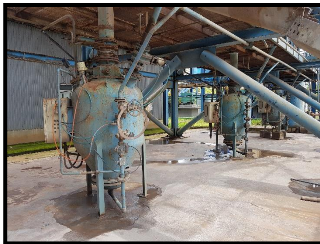
Gambar 2. 21 Vessel Tank (Sumber: Dokumentasi Pribadi)
