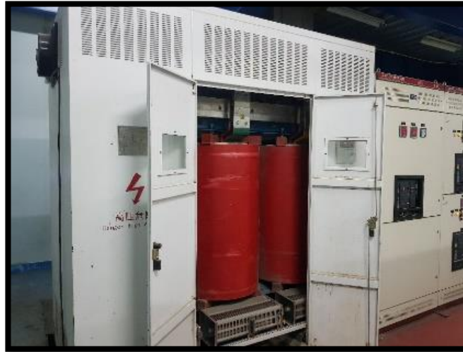
Gambar 2. 34 Trafo PS pada PLTU Baturaja (Sumber: Dokumentasi Pribadi)
