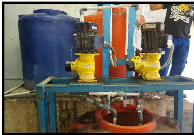
Gambar 2. 9 Dosing Pump (Sumber: Dokumentasi Pribadi)
