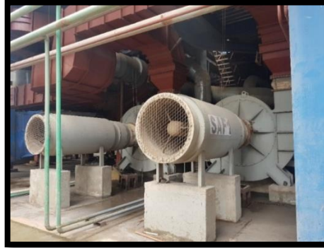
Gambar 2. 17 Secondary Air Fan (Sumber: Dokumentasi Pribadi)
