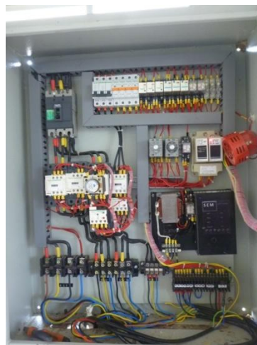
Gambar 2.12 Perlengkapan Hubung Bagi
