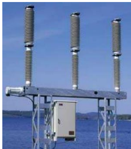
Gambar 2.5 PMT Tegangan Tinggi
