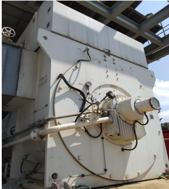
Gambar 2.5 Generator di PLTGU
