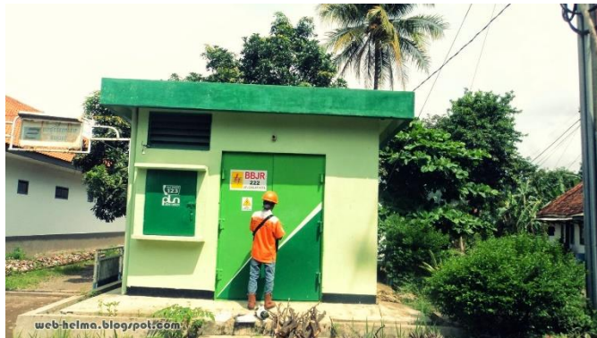
Gambar 2.6 Gardu Tipe Beton
