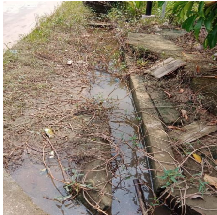
Gambar 1.5 Kondisi saluran yang rusak
