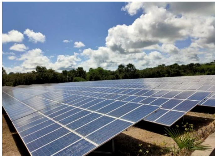
Gambar 2.1 Pembangkit Listrik Tenaga Surya (PLTS)
