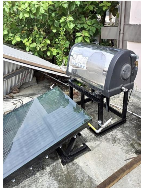
Gambar 22. Serangkaian Alat Solar Water Heater
