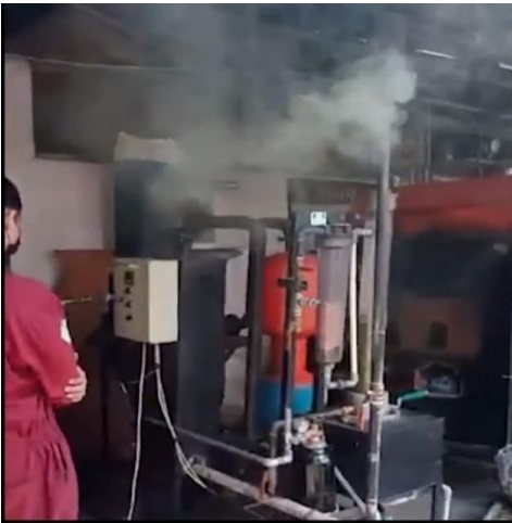
L3.18 Menyalakan blower dan membuka Oksigen
