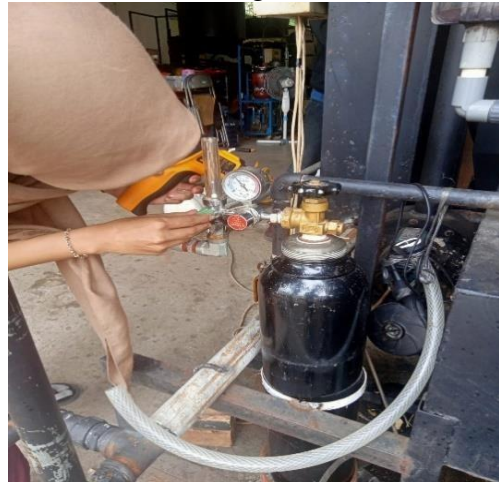
L3.19 Mengatur Laju Alir penuh valve pada sistem piping
