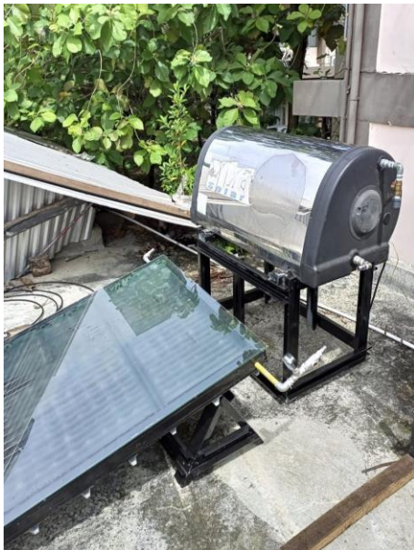
Gambar 22. Serangkaian Alat Solar Water Heater
