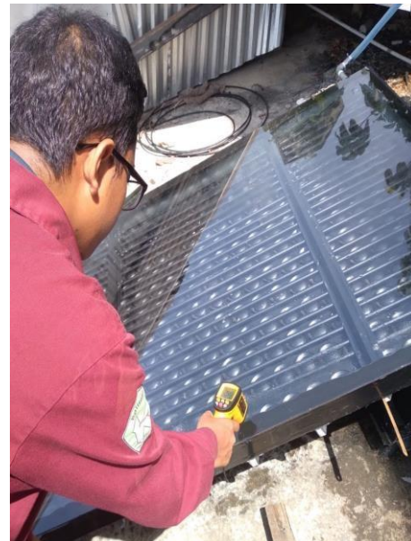
Gambar 28. Pengukuran Suhu Panel
