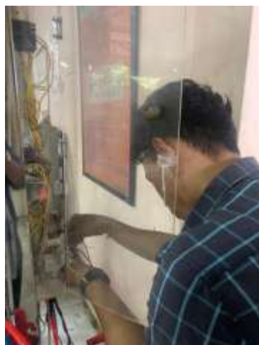
Pengambilan Data Listrik Chiller
