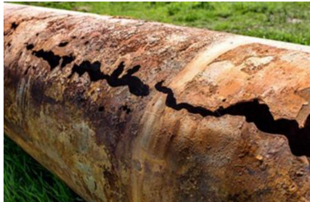
Gambar 2.5 Korosi Erosi pada Pipa (Karyono dkk.,2017)
