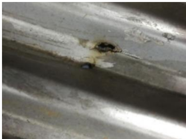
Gambar 2.4 Korosi Sumur pada Baja Akibat Ion klorida (Rahmadtulloh,2021)
