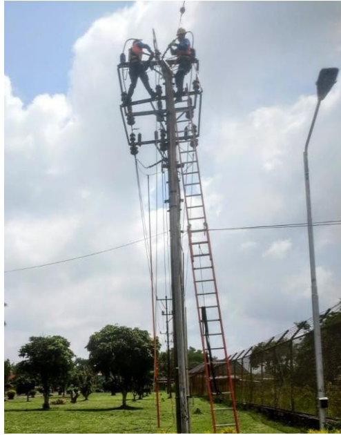
Gambar 5.2 Perbaikan ( Corrective Action ) pada Hot Spot
