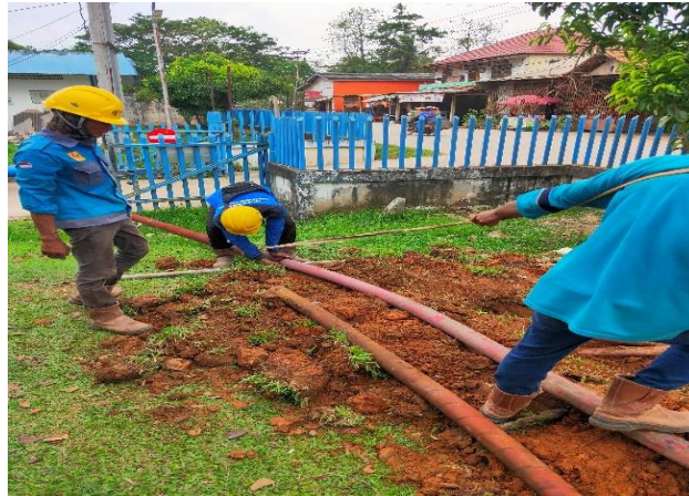
Gambar 2.3 Saluran Kabel Tegangan Menengah
