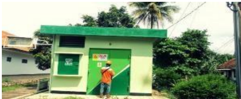
Gambar 2.9 Bangunan Gardu Distribusi Konstruksi Beton
