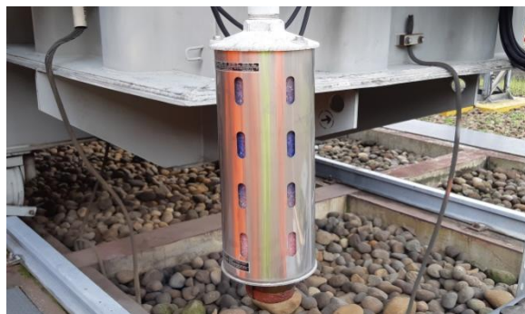
Gambar 2.8 Alat Pernafasan Trafo
