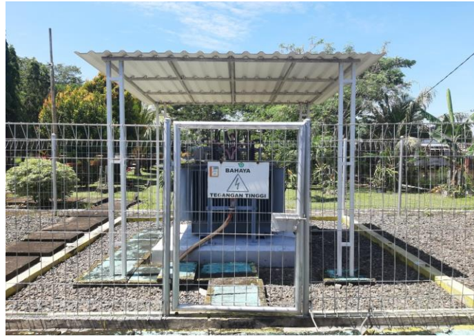
Gambar 2.11 Transformator Pemakaian Sendiri
