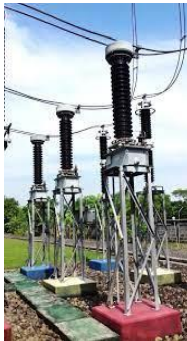
Gambar 2.1 Trafo Tegangan 150 kV
