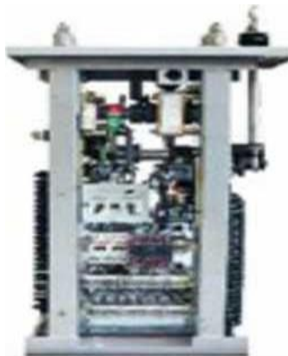
Gambar 2.14 Terminal dan Wiring control
