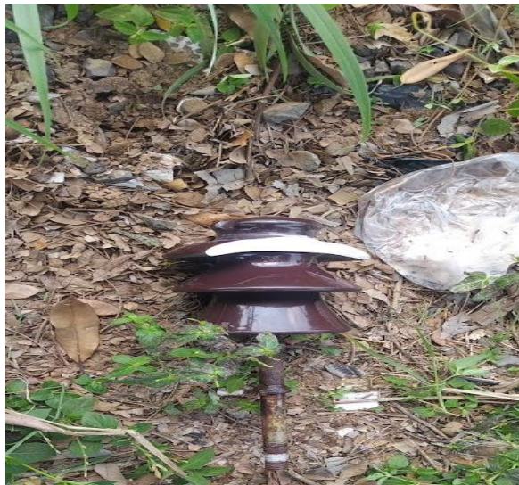
Gambar 2. 8 Gangguan akibat kerusakan peralatan Jaringan
