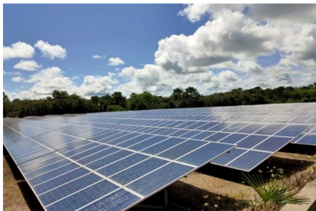
Gambar 2. 1 Pembangkit Listrik Tenaga Surya
