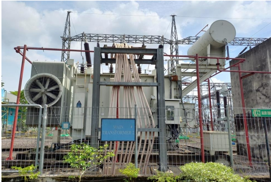
Data Visual Dari Transformator 150 kV/20 kV di PLTG Borang
