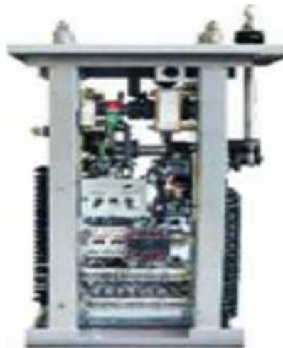
Gambar 2. 12. Terminal dan Wiring control
