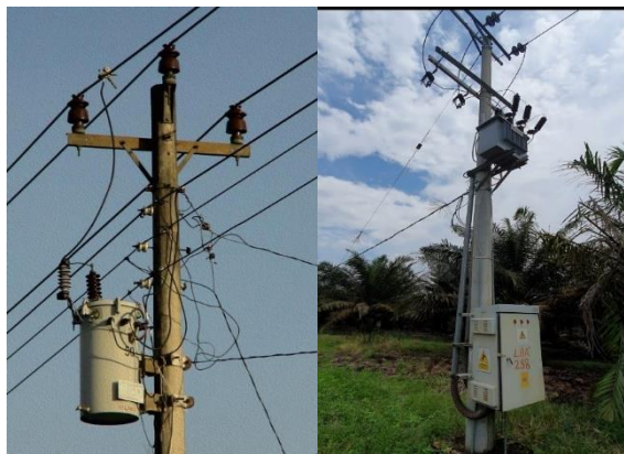
Gambar 2. 4 Gardu Cantol 1 Fasa (kiri) dan Gardu Cantol 3 Fasa
