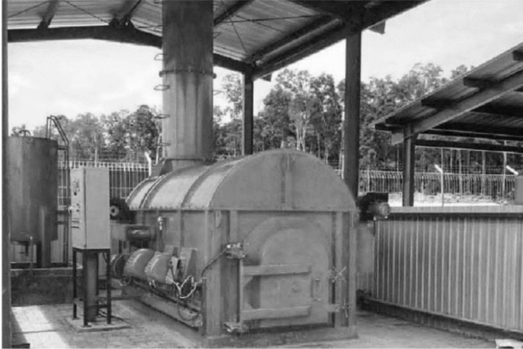
Gambar 3.12: Insinerator Pembakar Sampah
