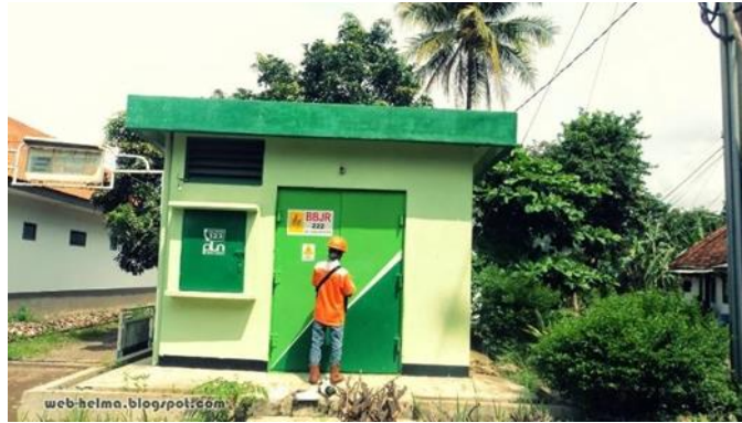
Gambar 2.8. Gardu Tipe Beton
