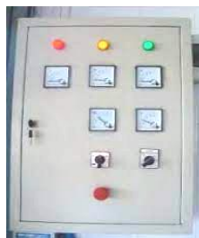
Gambar 2. 1 Panel Hubung Bagi
