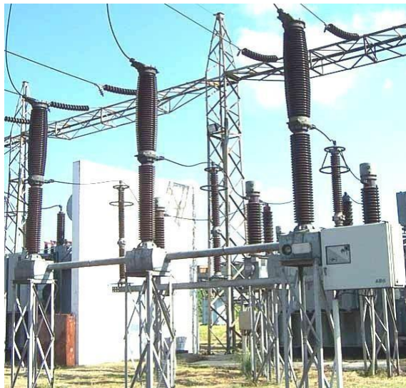
Gambar 2. 2. Pemutus Tenaga (PMT) 150KV
