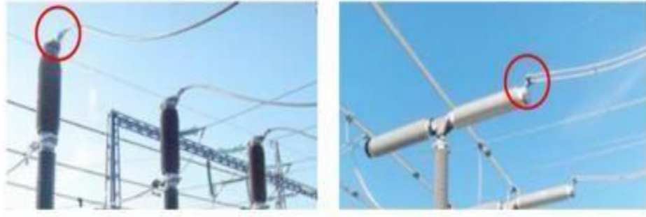
Gambar 2. 6. Terminal utama pemutus tenaga
