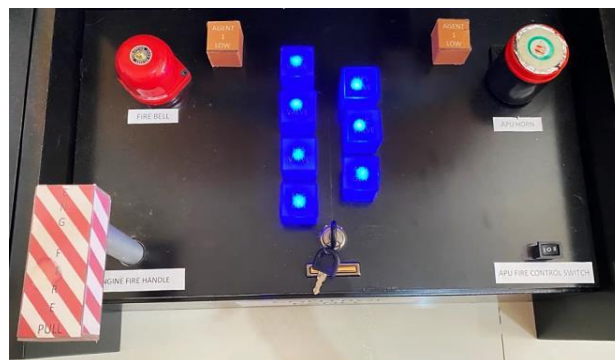
Gambar 7. Bagian Bawah Control Panel
