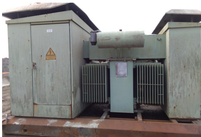
Gambar 2.9 Transformator tipe basah ONAN
