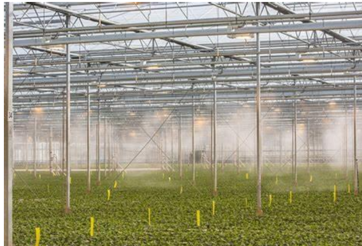
Gambar 2.2 Sistem Water Fogging pada Greenhouse
