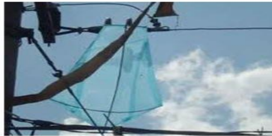
Gambar 2.10. Gangguan akibat layang-layang
