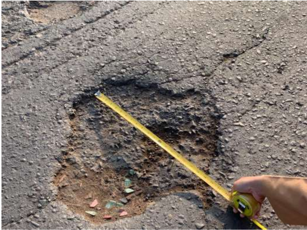
Gambar. Proses Pengukuran Dimensi Kerusakan
