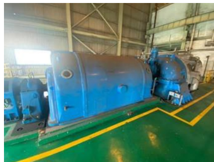
Gambar 2. 4 Generator PLTU TE 3x10 MW
