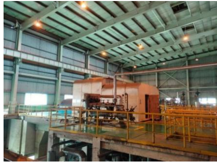
Gambar 2. 3 Casing Turbin PLTU TE 3x10 MW
