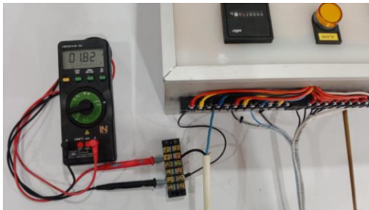
Pengukuran Arus Pada Pompa 1 dan 2
