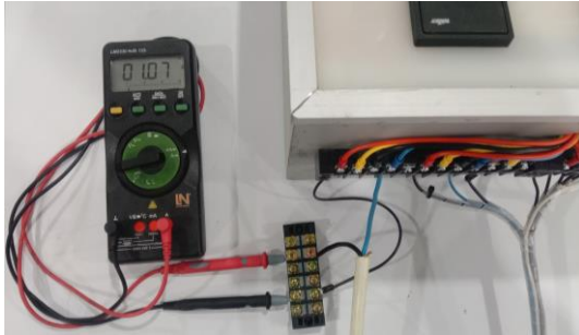
Pengukuran Arus Pada Pompa 1
