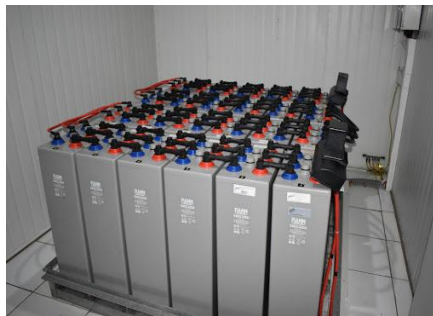
Gambar 2. 14 Baterai (Sumber : https://pasangpanelsurya.com/5-komponen-penting-untuk-membangun-plts/ )
