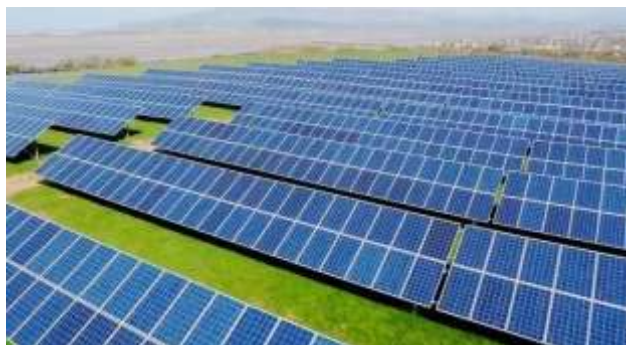
Gambar 2.2 Pembangkit Listrik Tenaga Surya (PLTS)
