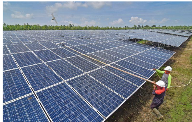
Gambar 2.2 Pembangkit Listrik Tenaga Surya (PLTS) 8
