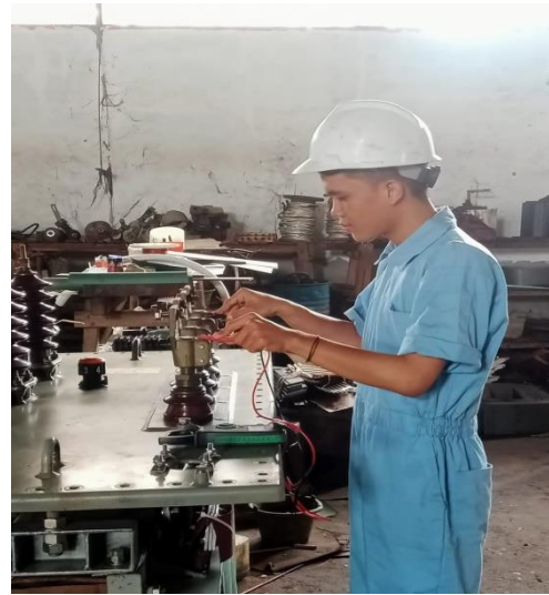
Gambar 2. Mengukur tegangan trafo
