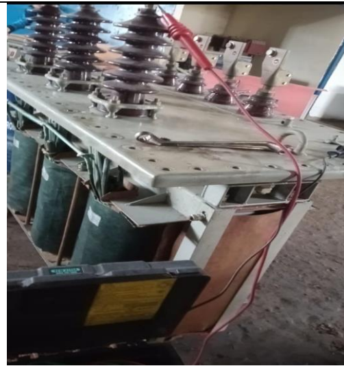
Gambar 4. Mengukur Tegangan Trafo Menggunakan Megger
