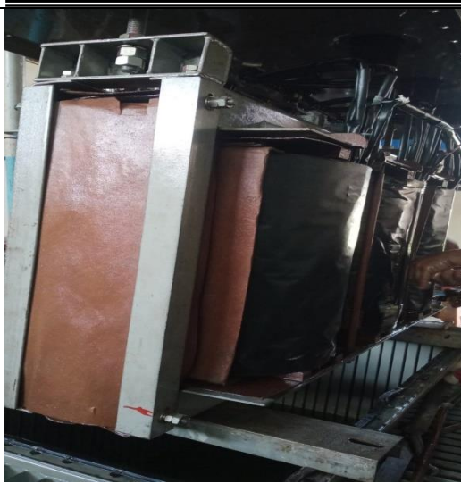
Gambar 5. Pengecekan Kerusakan Belitan Pada Trafo
