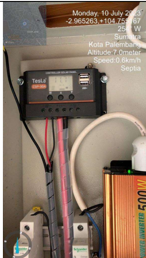
Tegangan DC (SCC) = 11,7 Volt
