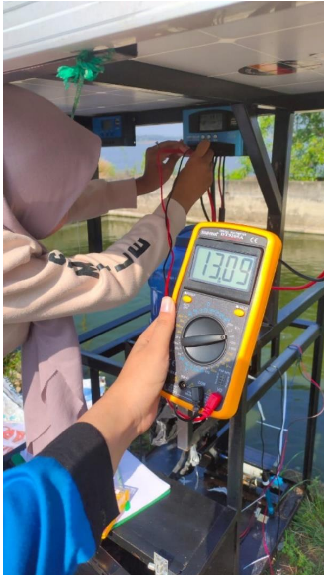
Gambar 3. Cara mengukur Tegangan atau arus pada SCC MPPT
