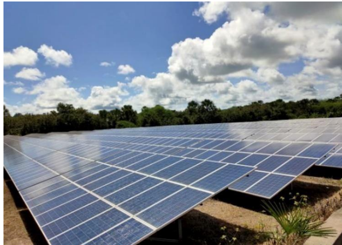
Gambar 2 1Pembangkit Listrik Tenaga Surya (PLTS)
