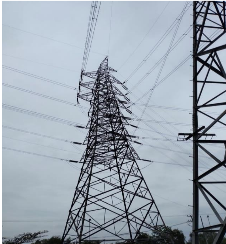
Gambar 2.11 Tower SUTT di GI Kenten
