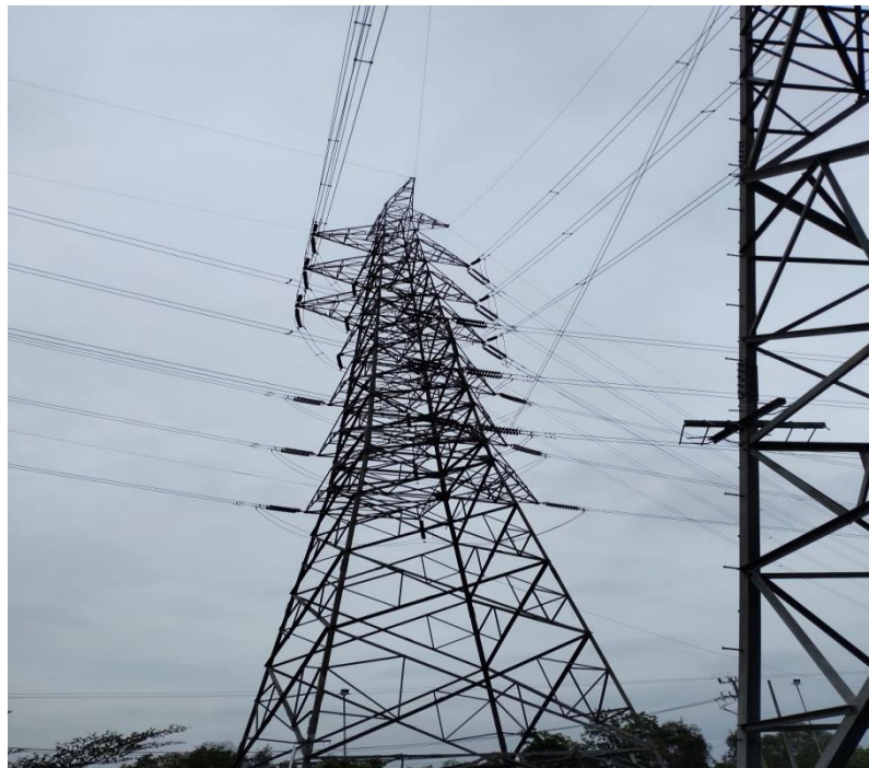
Gambar 2.27 Saluran Listrik Udara Tegangan Tinggi
